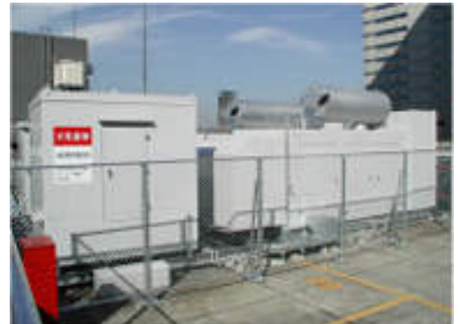
500kVA2台並列運転
